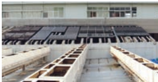
各種太陽光パネル設置
