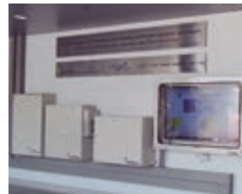
パワーコンディショナと発電モニター
